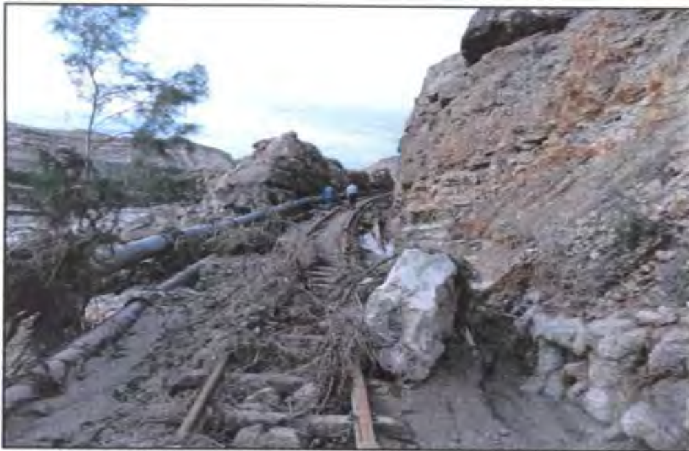
La destruction de la conduite d'amenée d'eau d'irrigation de Tebedit à l'Oasis de Richet Naam (région de Metlaoui, Gouvernerat de Cafsa)
