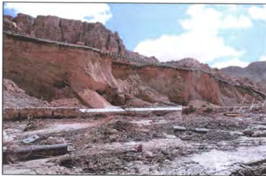
La destruction de la voie ferrée de la Compagnie Phosphate Gafsa (région de Redeyef, Gouvernerat de Cafsas)
